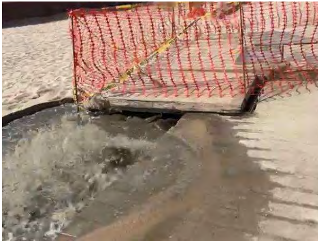
Cárcamo Los Arcos
